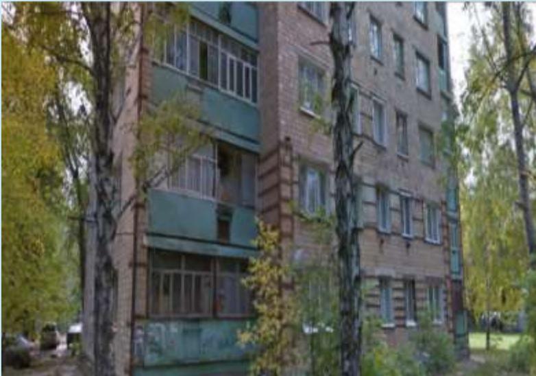
Аварийный дом по ул. Полбина, 26
